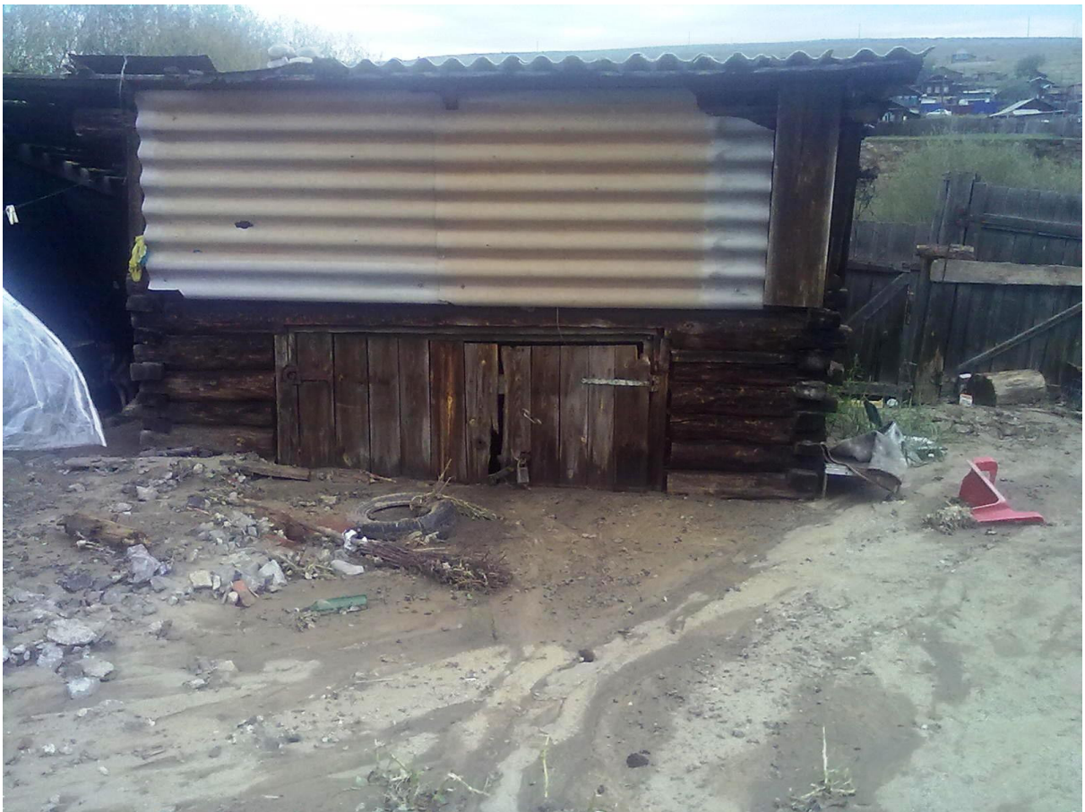
Рис. 1.2.2.2. Проявления эрозионных процессов в частном секторе г. Кяхта
