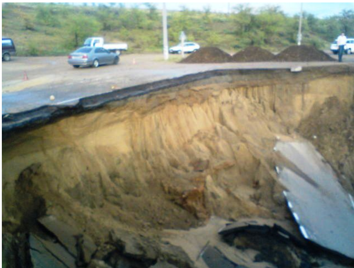
Рис. 1.2.2.2.1. Проявление эрозионных процессов на автодороге А-165 Улан-Удэ – Кяхта
