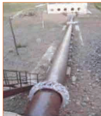
Зураг 78. УЦС-ын байшин, түрэлтэт хоолой
